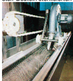
23 • Abwassertechnik, hier Separator mit Reinigungsvorrichtung.
